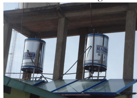
Größere Tanks für die Warmwassersolaranlage in Karipuyo
