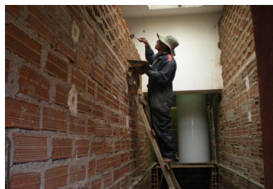
In Sakaka mussten die sanitären Anlagen renoviert werden. Auf dem Bild sieht man, wie Trennmauern im Sanitärbereich gezogen werden.
